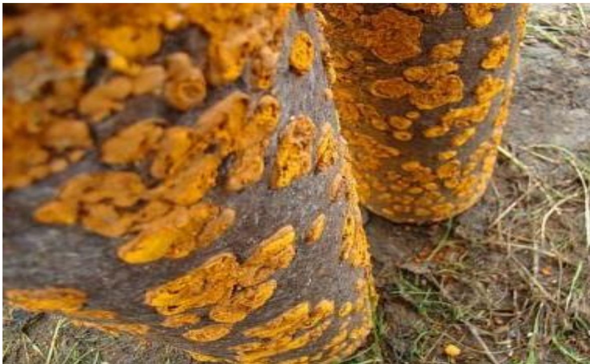
Рисунок 2. Проявление коррозии на металлических поверхностях.
